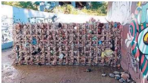
Residuos sólidos retenidos en un aliviadero
